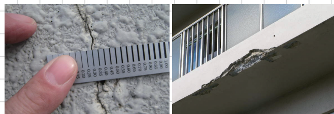
建物の表面に発生したクラック。クラックからCO 2 や雨水が入ると、中性化や鉄筋のさびを早めてしまいます。さらに腐食を加速させてしまいます。 鉄筋にさびが発生すると、コンクリートがひび割れやはく離を起こし、中性化や鉄筋のさびを早めてしまいます。さらに腐食を加速させてしまいます。
