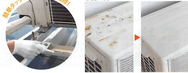
エアコン室外機標準色でタッチアップ補修 ※サビがひどい場合は事前にサビキラープロを塗布することでより防錆効果は高くなります。
