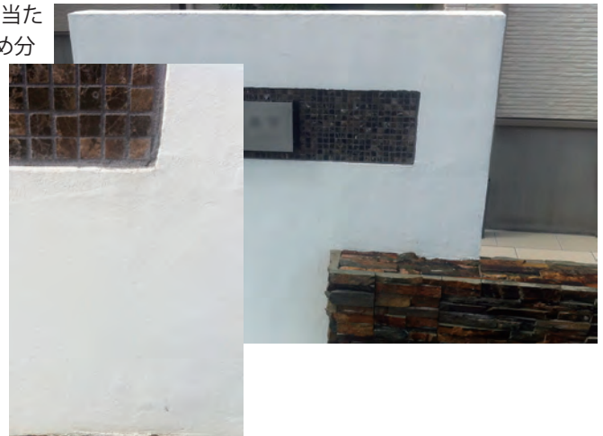
※新築時にサーファシールドCを塗布し、施工後7ヶ月経過後の門柱
