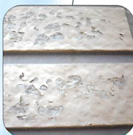
浮き・はがれ
